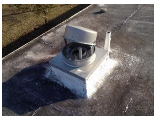
Damaged roof fan
