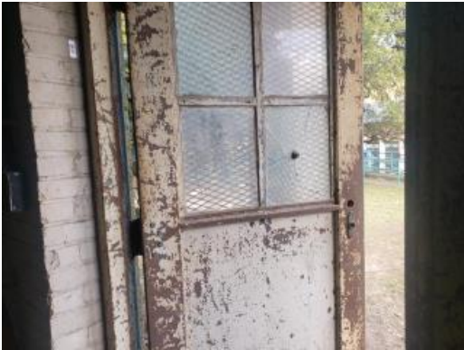
Exterior metal door beyond useful life
